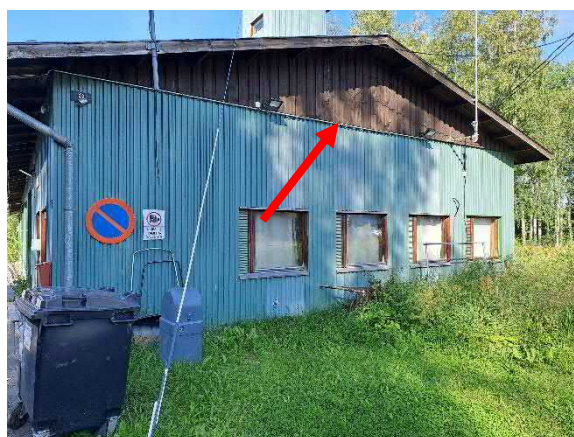
Kulkuluukku yläpohjaan, johon ei ole tikkaita
