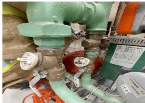
Alkuperäiset sulku- ja linjasäätöventtiilit ovat saavuttaneet teknisen käyttöikänsä.
