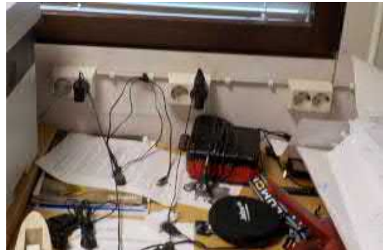
Käyttäjien laitteiden sähköistystä toimistossa
