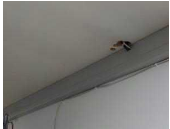
Johtokanavaa kaapelireittinä kokoustilassa
