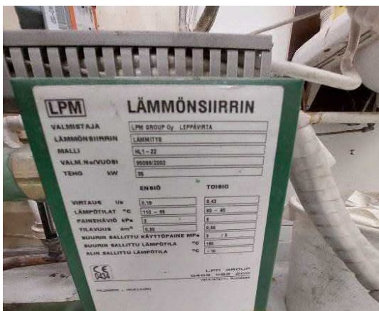
Alkuperäinen lämmitysverkoston lämmönsiirrin, tekninen käyttöikä ylittynyt.
