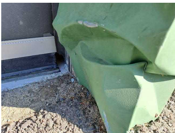
Nosto-ovien vierellä pellityksessä vaurioita
