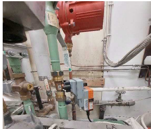
Vuonna 2018 uusitut säätöventtiilit.
