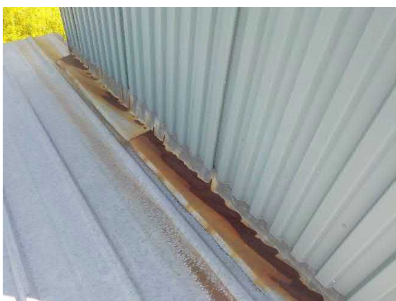
Ruostejälkiä letkutornin ympärillä
