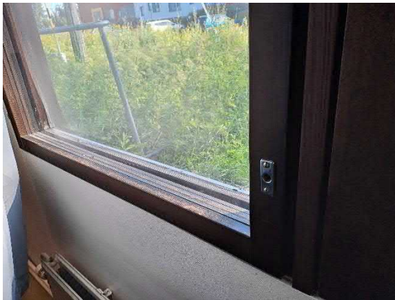
Koulutustilan ikkunan sisäpuutteessa maalipinnan vaurioita
