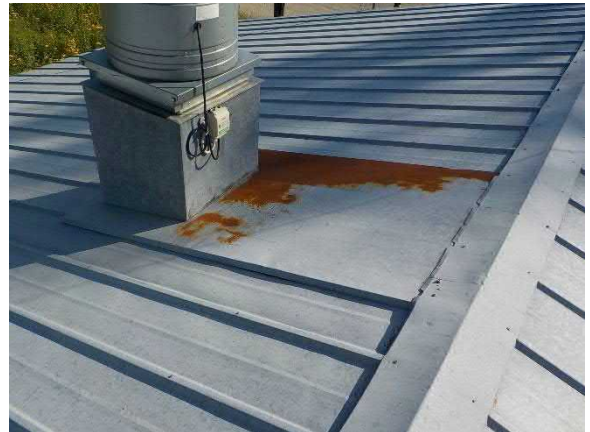
Ruostejälkiä huippuimurin vierellä
