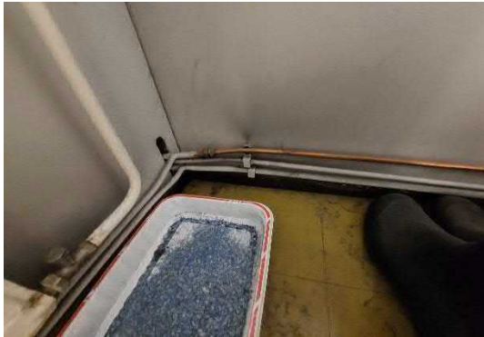
Käyttövesijohtojen läpiviennit puutteellisia.
