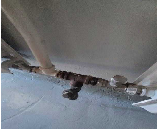
Ruostetta patterin kytkentäputkessa.
