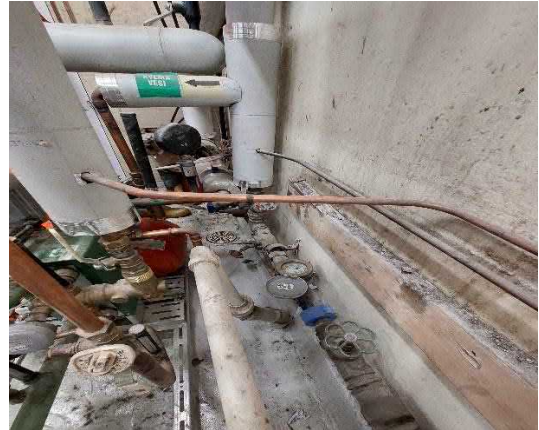
Päävesimittari ja alkuperäiset sulkuventtiilit.
