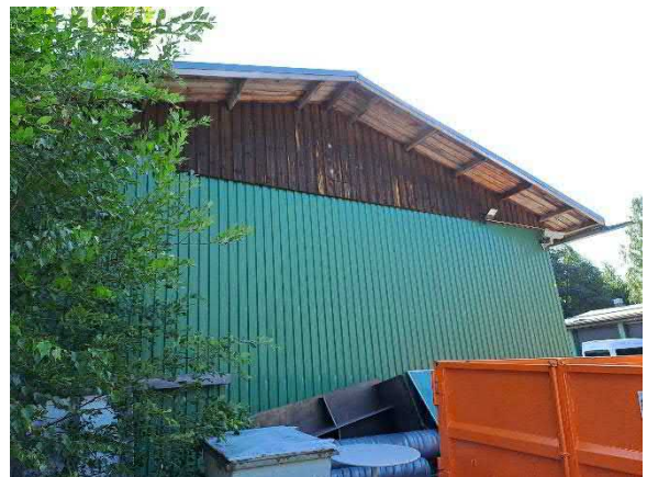
Länsipäädyn puuosissa vaurioita/maalipinnan kulumaa
