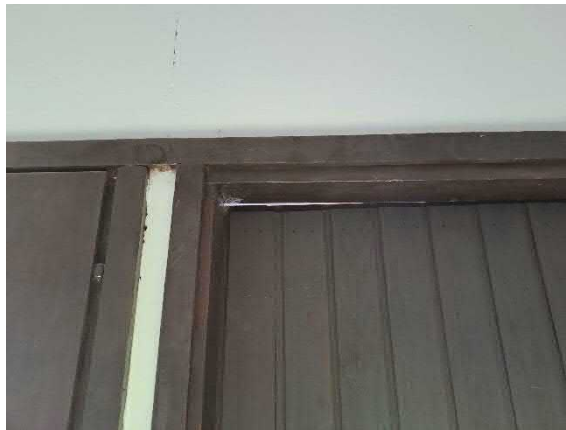
Puu-ulko-oven yläreuna ei tiivisty karmiin
