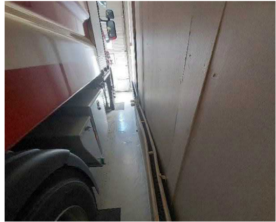
Kolhiintunut lämmityspatteri autohallissa.
