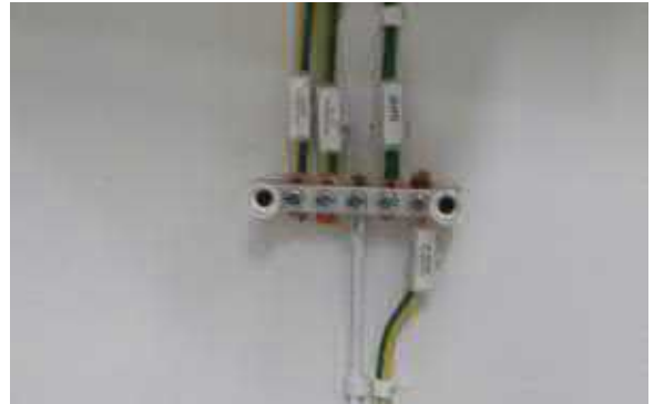
Maadoituskisko pääkeskuksen yhteydessä
