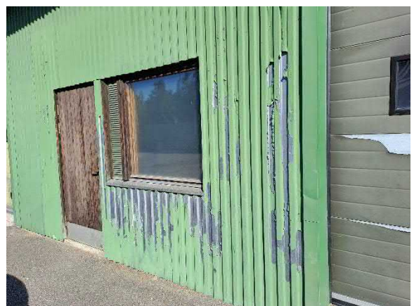
Työpaikan julkisivujen profiilipelleissä pinnoite- vaurioita
