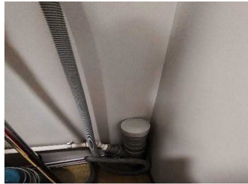
Alkuperäinen muovinen tuuletusviemäri ja alipaineventtiili.
